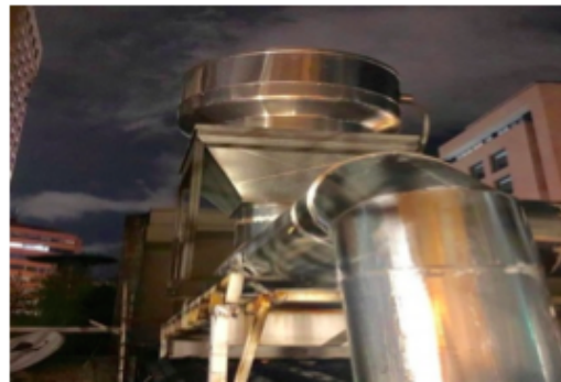
Fotografía 8. Ducto y sistema de extracción.
